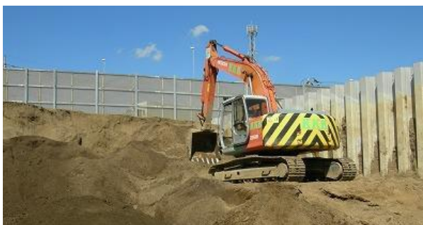
改良土ストック施設 ..... 敷地面積 700 m 2 保有数量 3,600 m 3
