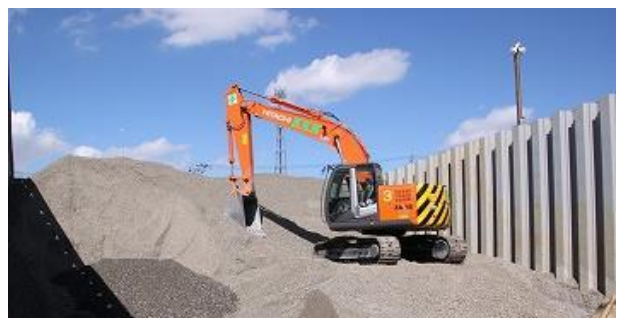
再生砕石 (RC・RM) ストック施設 ... 敷地面積 700 m 2 保有数量 3,600 m 3
